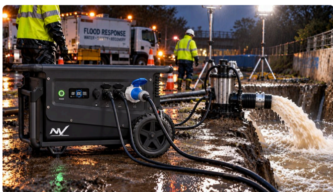
Pompage de secours
